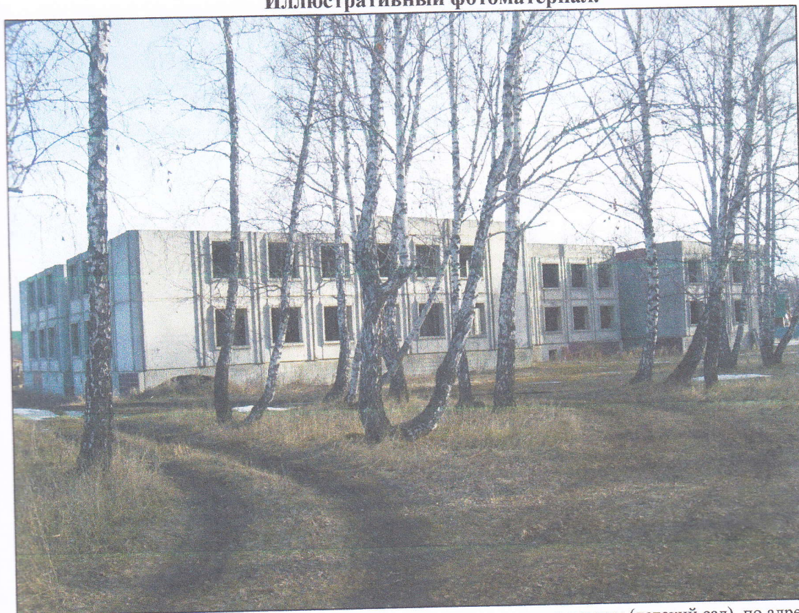
Фото 1. Вид на объект оценки – здание незавершенное строительством (детский сад), по адресу: Челябинская область, п.Ишалино, ул.Новая, д.36. Направление окон – север.
